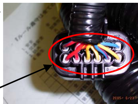
電気配線（拡大）
