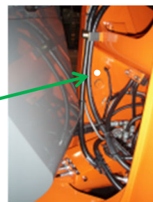
車両フロントフレーム内左側
