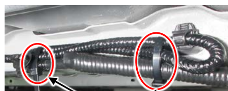
【車両下面視(改善後)】
